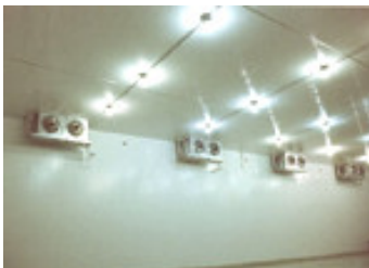
Fig.4 Câmara frigorífica (Fonte: http://york.com )
