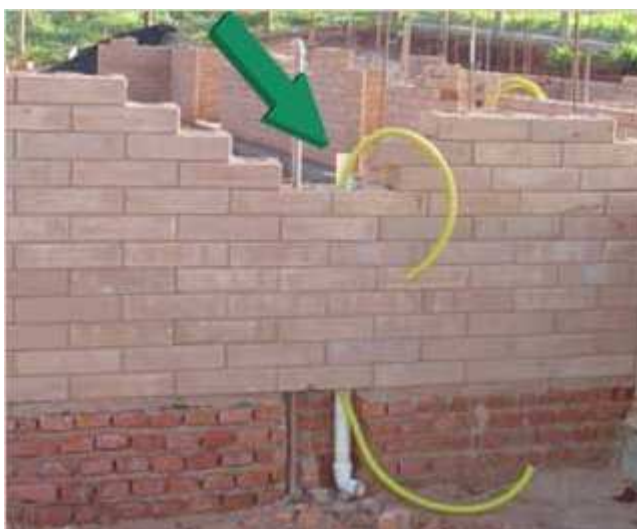
Figura 4 – Entradas elétricas e hidráulicas Fonte: TIJOL-ECO
