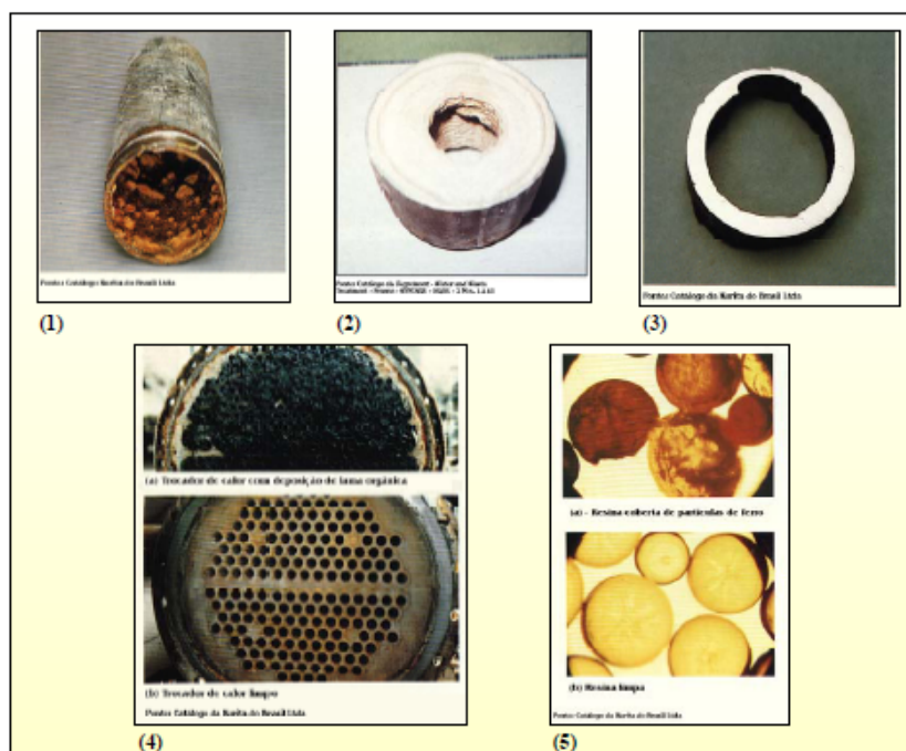
Figura 6 - Problemas associados à qualidade da água para uso industrial – (1) Corrosão alveolar em tubulação do sistema de refrigeração; (2) Incrustação em tubulação de sistema de refrigeração; (3) Corrosão devido à presença de gás carbônico em caldeira; (4) Depósito de lama orgânica em trocador de calor e (5) Depósito de partículas de ferro em resinas de troca iônica.
