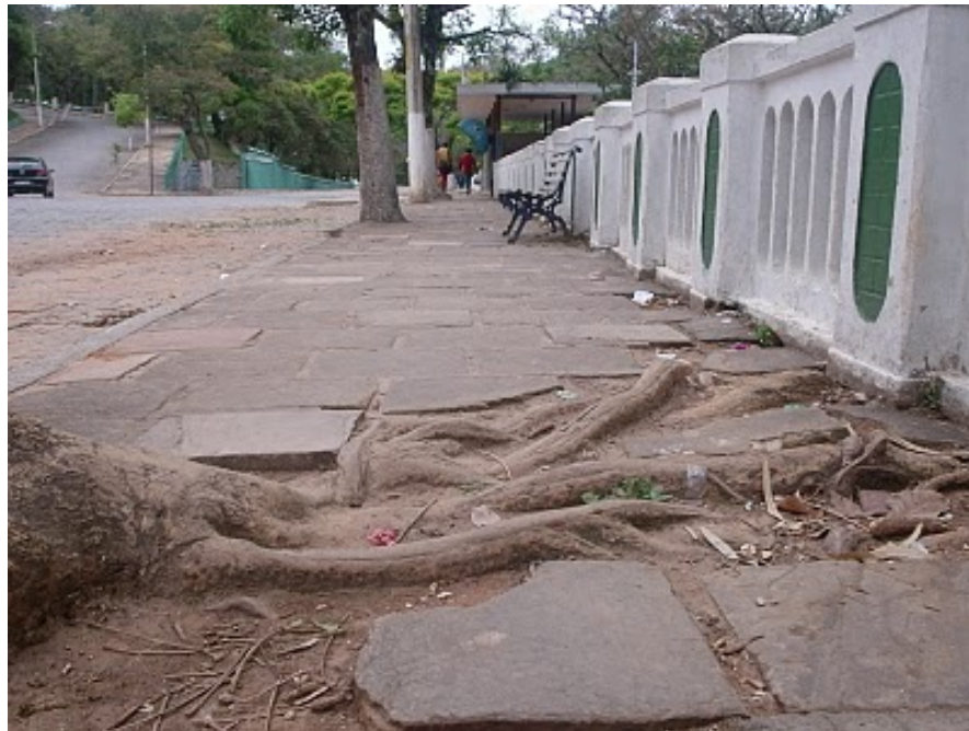
Figura 18 – Calçada danificada por raízes Fonte: (CAMBUQUIRA AGORA, [20--?])
