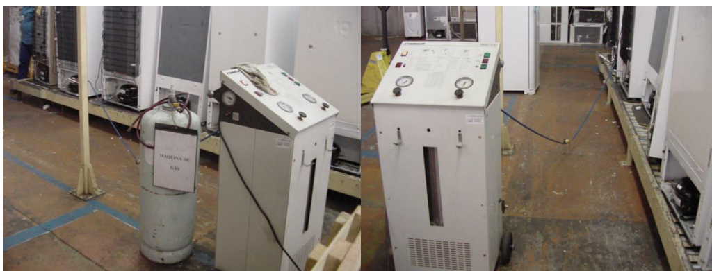
Figura 10 – Retirada dos gases Fonte: (CEAL, [200?])
