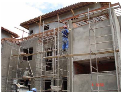
Figura 15: Plataforma de trabalho insuficiente Fonte: SESI
