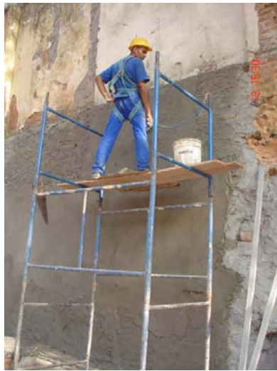
Figura 12: Cinto de segurança preso na própria estrutura do andaime Fonte: SESI
