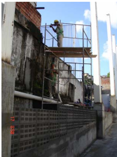
Figura 13 – Montagem do andaime de forma irregular e em local inadequado. Fonte: SESI
