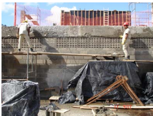
Figura 14 – Andaime improvisado em precárias condições somada a falta de EPI's nos trabalhadores. Fonte: SESI
