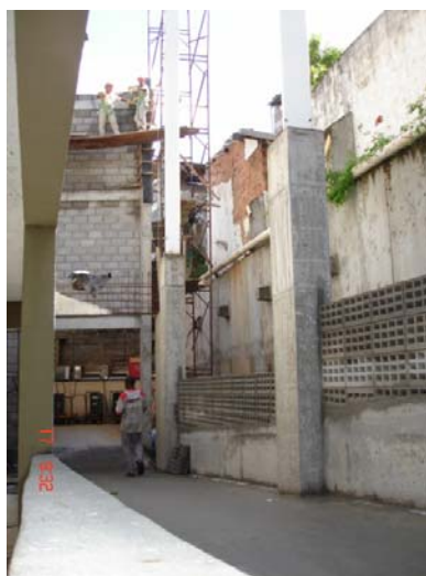
Figura 10: Trabalhador circulando em área não sinalizada e sob plataforma sem guarda-corpo e rodapé. Fonte: SESI
