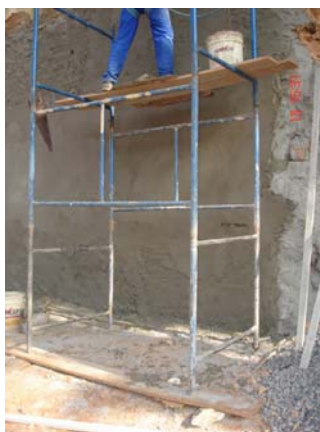
Figura 7 – Andaime simplesmente apoiado com base de sustentação irregular. Fonte: SESI
