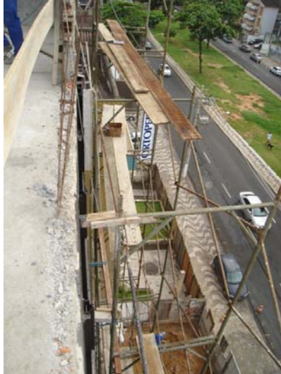
Figura 11 – Montagem de andaime mal projetada e defeituosa Fonte: SESI
