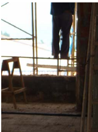
Figura 8: Cavaletes com distância excessiva Fonte: SESI
